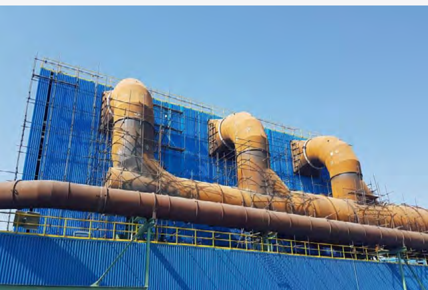
تصویر ۳- داکت‌های اتصالی به هود سقفی (Canopy Hood) در قسمت فوقانی کوره قوس الکتریکی
